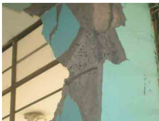
写真一 2 : 柱と梁の接合部の亀裂
