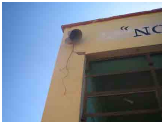
写真一 3 : 外部・柱と梁の亀裂
