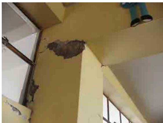
写真—3：柱と梁の亀裂
