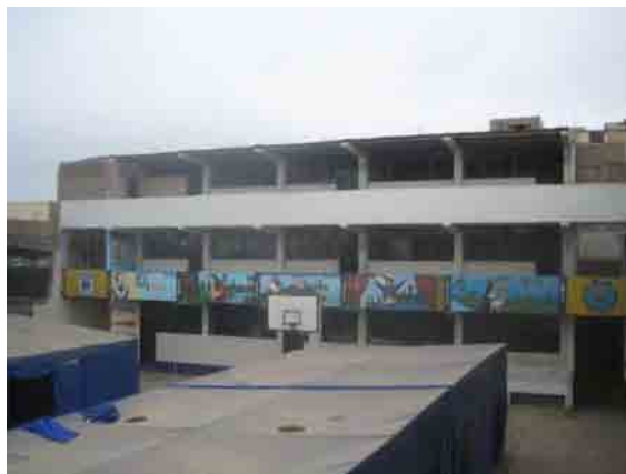
写真—1：損壊した教室棟と仮設教室
