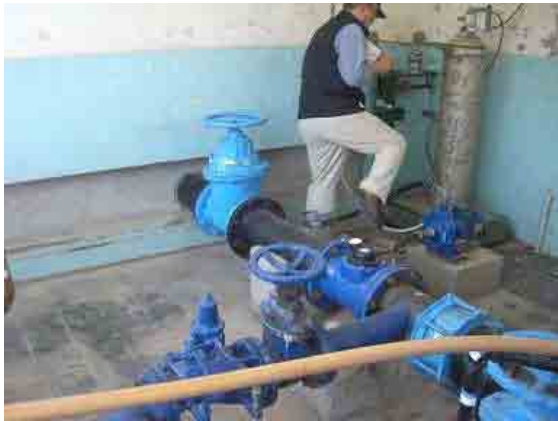
写真一 3 : 第二ポンプ場・NO.2 ポンプ
