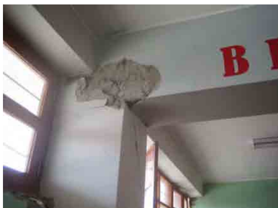
写真一 3 : 柱と梁の亀裂
