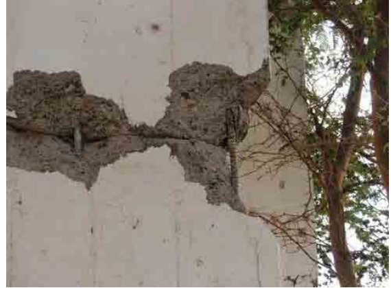
写真一 2 : 外壁の亀裂
