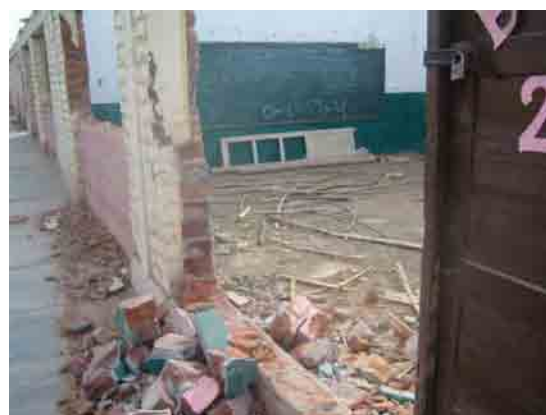
写真—2：地震で損壊した教室
