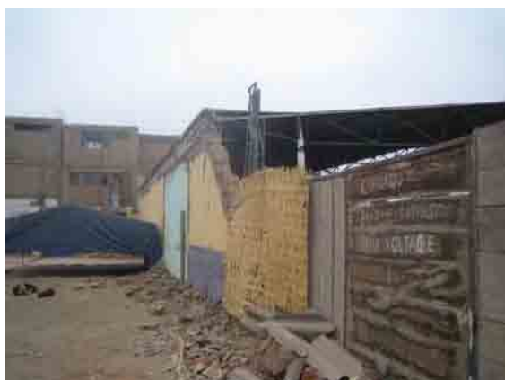
写真—3：損壊した実習教室
