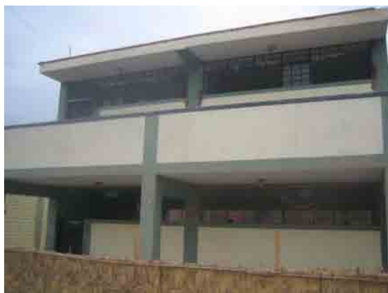
写真一 1 : 損壊した教室棟の外観
