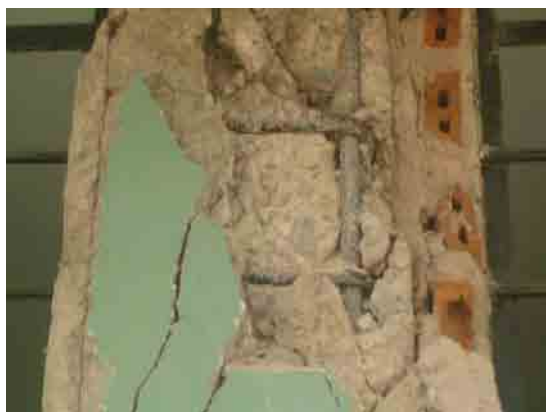
写真一 3 : 柱の損壊状況
