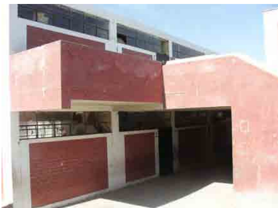
写真—1：損壊した教室棟の外観
