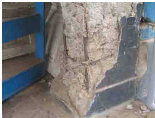
写真一 2 : 被災した柱脚
