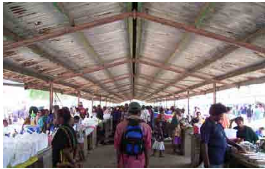
ウエワク市場／市場棟：建物は築後 27 年経ち老朽化が進んでいる。屋根は所々穴が開き、鉄骨も錆による腐食が激しい。
