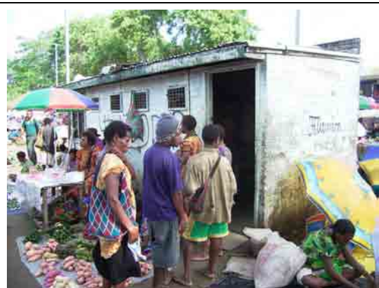
ウエワク市場／倉庫：清掃用具が保管され、机が1台置かれ、事務作業も行われている。建物は老朽化している。
