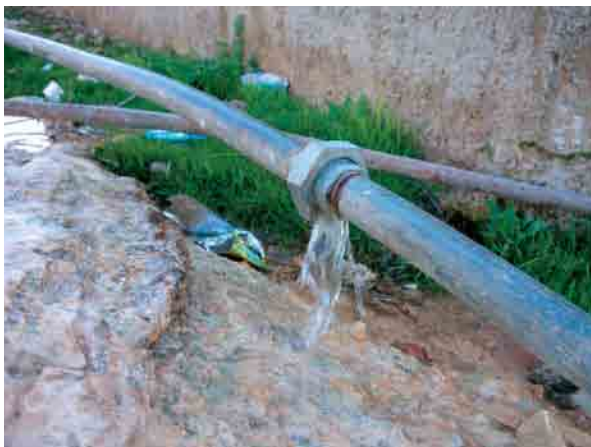
写真21 配水管からの漏水
