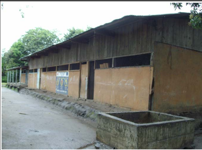
写真 3 : 老朽化した木造校舎。解体が必要。Adilia Irias, Jalapa市, Nueva Segovia県 (N5)
