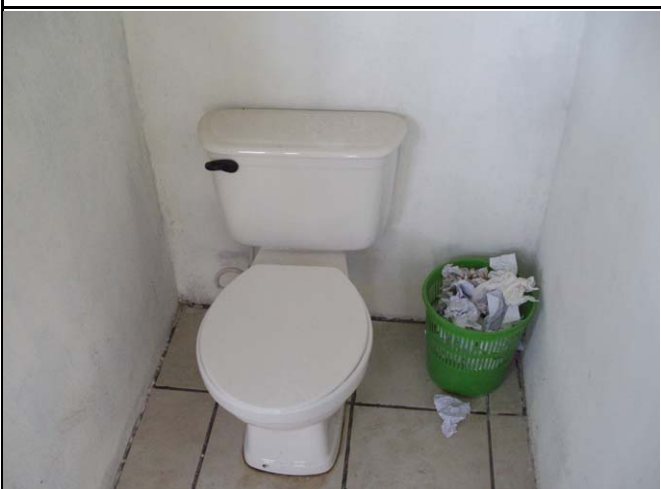
写真 29 : IMF資金により建設された水洗トイレ内部 María Llanes Rodoríguez, Estelí市, Estelí県 (E5)
