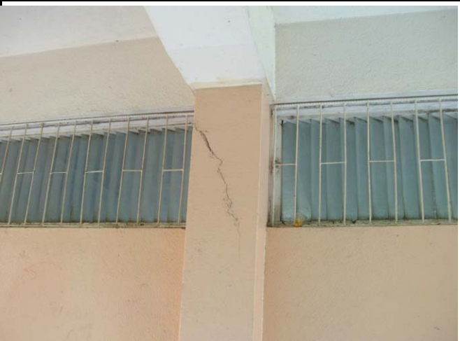
写真15：3階建校舎の1階および2階の柱には大きなクラックが生じている。地下水脈による不等沈下と見られる。すでに危険な状態であり、早期解体が望まれる。Eliseo Picado, Matagalpa市, Matagalpa県 (要請校リストから除外された)
