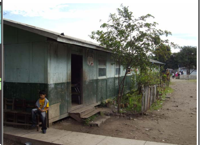
写真 2 : 老朽化した木造校舎 (1989年建設) María Llianes Rodoriguez, Estelí市, Estelí県 (E5)
