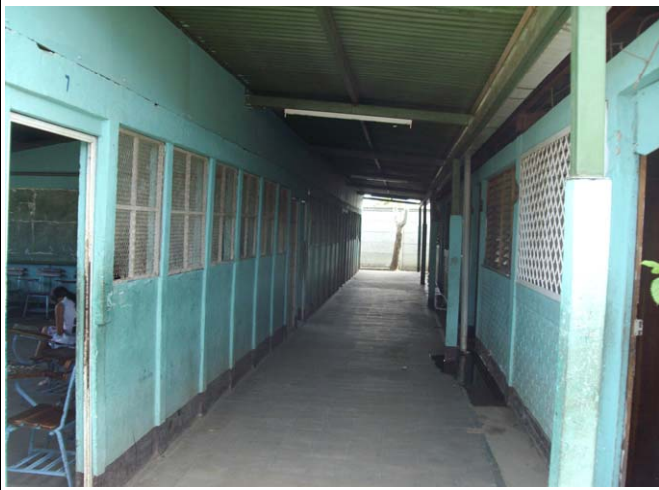
写真 1 : 老朽化した既存校舎 (1989, 1996年建設) Reino de Suecia, Estelí市, Estelí県 (E4)
