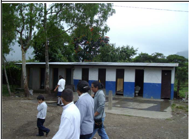
写真11：水洗便所。清掃状態は良好だが水洗設備が故障しているため水を流せない。水量は豊富。José Dolores Rivera, Jinotega市, Jinotega県 (J5)
