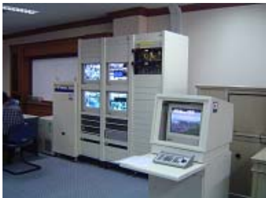
タンジュンプリオク港のオペレーションルームに設置されている CCTV カメラ監視システムのモニター、レコーダー等
