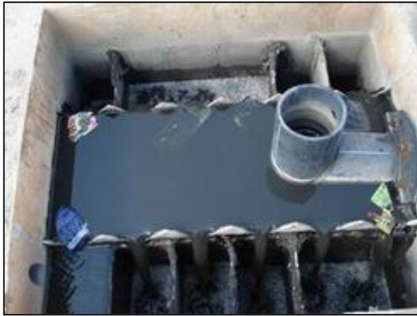
管渠が閉塞しているため分水が不均等な UASB 分水槽（アグラ市）
