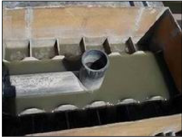
均等分水され適正に機能している UASB 分水槽（カルナル市）
