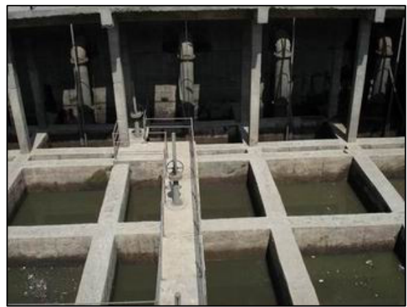
維持管理用に複数に仕切られた良好な 状態のポンプ井（ガジアバード市）
