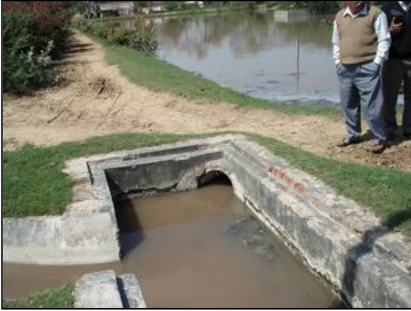
維持管理が不適切な処理場における放流水の状況（ブリンダバン市・安定化池）
