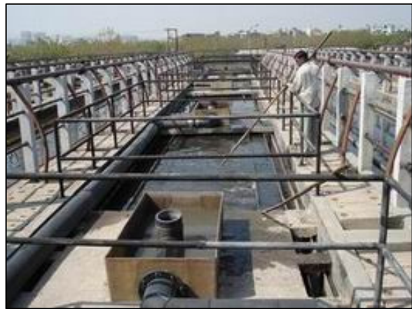
管渠が閉塞しているため分水が不均等な UASB 分水槽（ガジアバード市）
