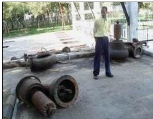
故障し放置されているポンプ （ファリダバード市）
