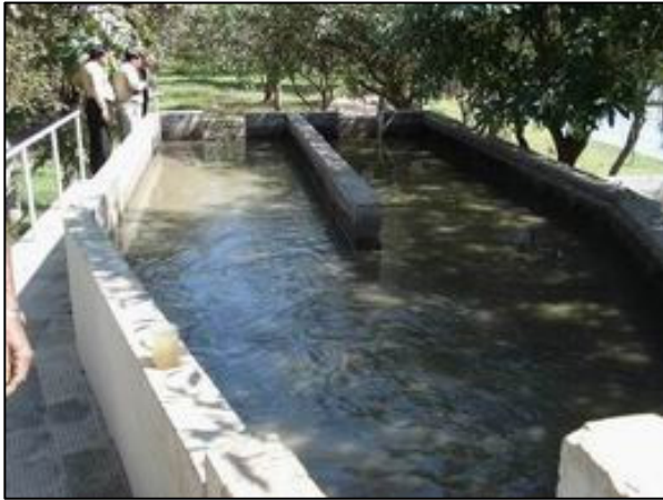
容量不足の沈砂池
