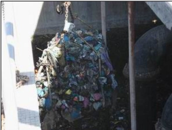
仕切り壁がなく維持管理が困難なポンプ井 と大量のプラスチック袋（カルナル市）
