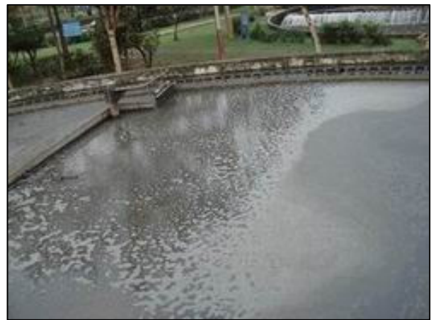
汚泥引き頻度が不適切な沈殿池 (バラナシ市・最初沈殿池)
