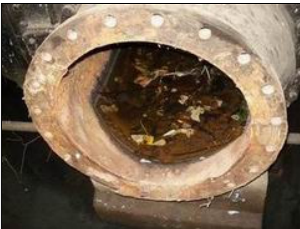
故障しているポンプ（アグラ市）
