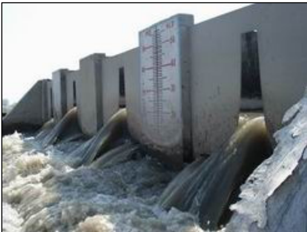
目盛り精度が粗い流量計測堰 (ガジアバード市)
