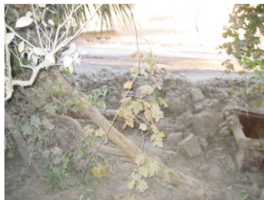
地震で崩壊したまま放置されている圃場の土塀
