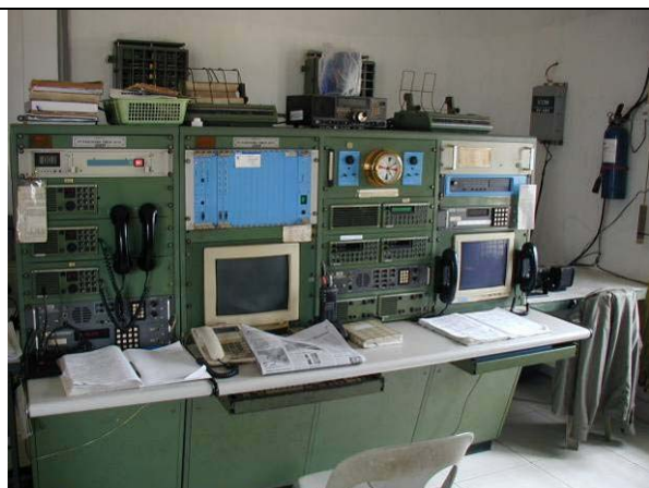
写真 3-5： 沿岸無線局内通信機器類
