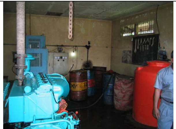
写真 8-4： 自家発電機（商用電力が供給されているが、電力事情が悪く停電の頻度が高いため、自家発電機が設置されている。）
