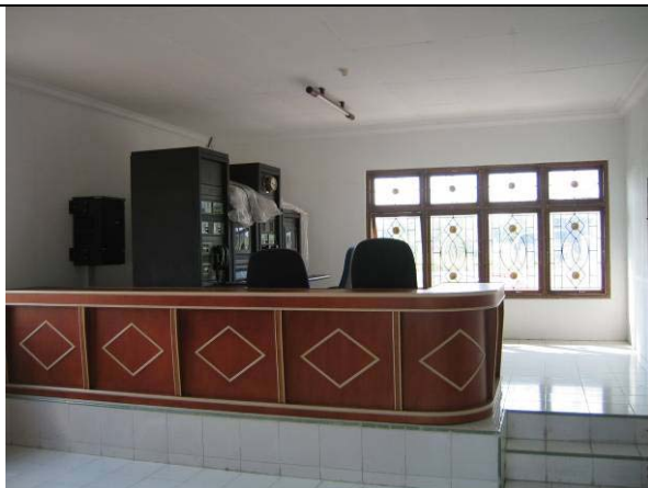
写真 7-5： 沿岸無線局の通信機器類
