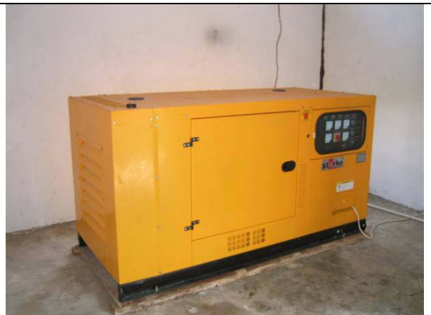
写真 7-6： 自家発電機（商用電力が供給されているが、同地の電力需要を賄えず停電が頻発しているため、発電機の設置は必須である。）
