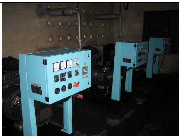
写真 5-6： 既存自家発電機（商用電力の供給が無い場合、灯台灯器及び宿舎用電力は自家発電により供給されている。）
