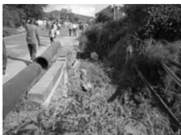
Bas côté de la route fortement érodé au No.2 +40 (près du ponceau rectangulaire)
