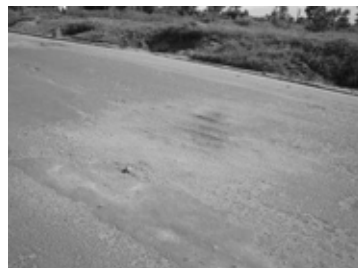
Etat de la chaussée près du point de départ (nid de poule comblé par des matériaux inadéquats)
