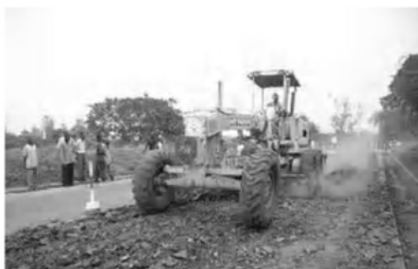
Date : 7/11/2007 ~ 26/11/2007 Activity : RN7 Excavation of the Existing Pavement Layer Sta. -0+025 ~ 0+240 Left Side Sta. 0+280 ~ 1+500 Left Side
