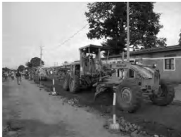
Date : 14/11/2007 ~ 30/11/2007 Activity : RN7 Sub-base Soil Spreading Sta. -0+025 ~ 0+240 Left Side Sta. 0+280 ~ 1+500 Left Side
