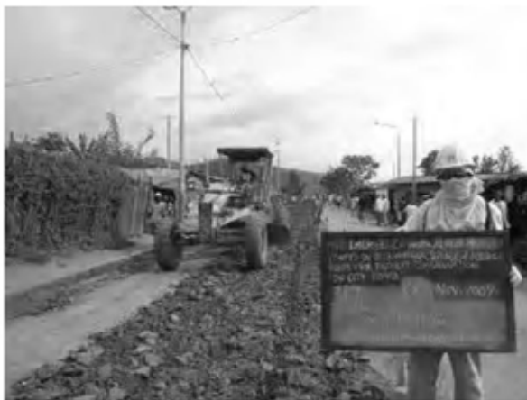
Date : 14/11/2007 ~ 30/11/2007 Activity : RN7 Sub-base Scarification Ripping Sta. -0+025 ~ 0+240 Left Side Sta. 0+280 ~ 1+500 Left Side
