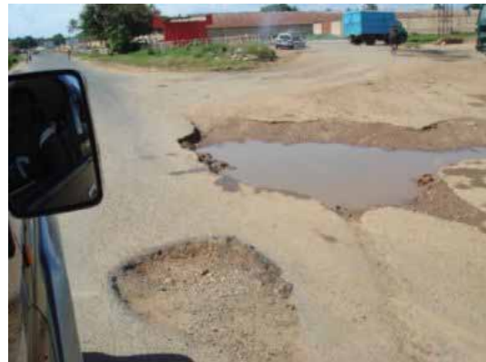
老朽化した路面
