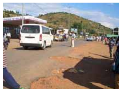
破損した路肩
