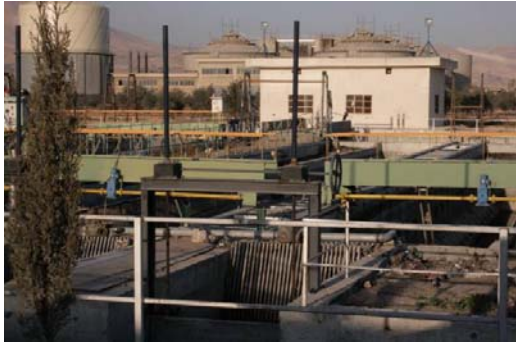
写真 3-3 アドラ処理場のオイル セパレータ
