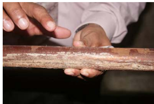
写真 2-17 UV 蛍光管の保護管に付着したスケール
