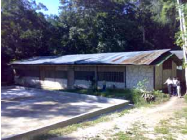
写真 13: 収蔵庫1。ティカルから出土した約 2000 点の遺物を収蔵している。老朽化が激しく改築を計画中。写真手前は現在建設中の収蔵庫。
