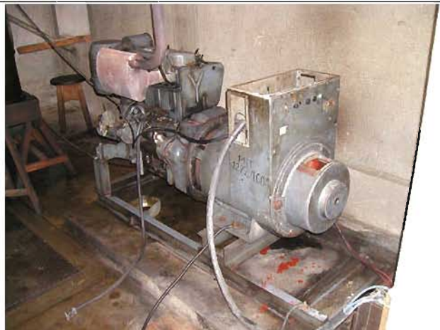
写真-2: 非常用発電機
