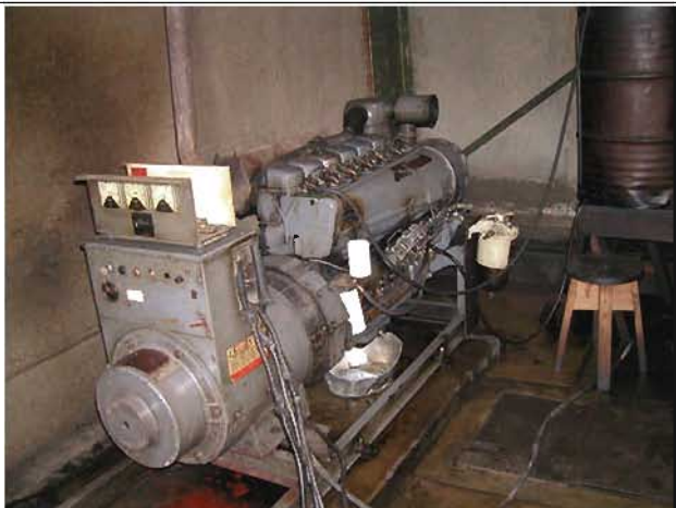
写真-1: 非常用発電機
