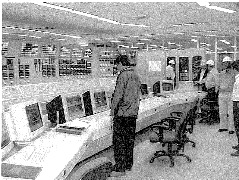
バクreshワール火力発電所制御室
