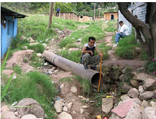
エル・レパルト地区の下部ブロック 雨水排水時（管路）に洗掘された箇所。 水路と集水枡の整備が必要である。
