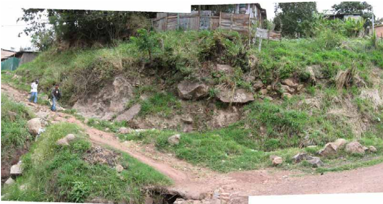
末端部の崩積土の状況。下部 はチキート層赤色凝灰岩。
