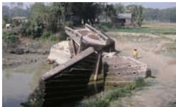
雨季の洪水により破損したコンクリート橋
