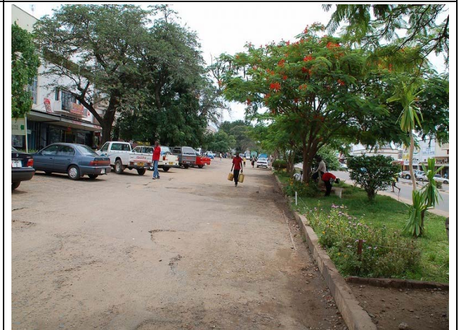
写真-6: 市街地中心部。本線に併設する駐車帯 舗装表面の大部分は損傷して剥がれた状態にある。
