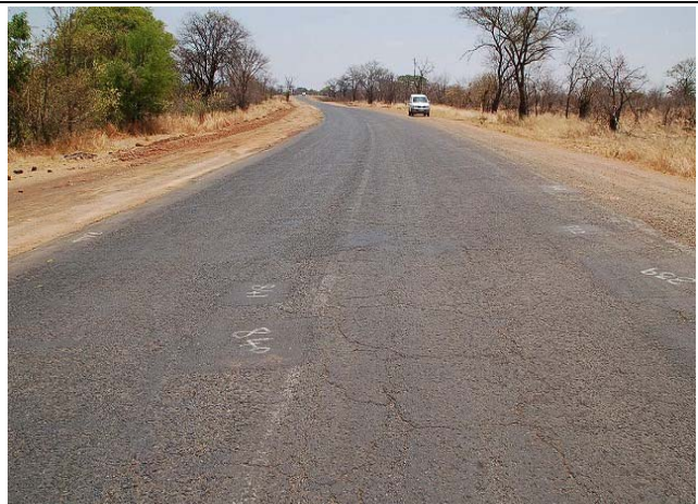
写真-5: 国立公園～終点区間 舗装表面に、ひび割れが多数見られる損傷状況。
