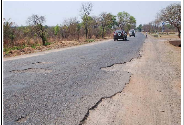
写真-4: 国立公園～終点区間 舗装の路肩部分が剥がれた状態で損傷している。
