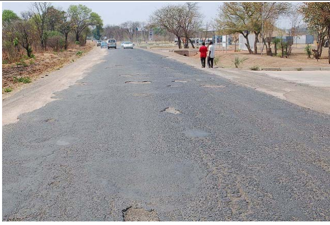
写真-3: 鉄道交差点～国立公園区間 舗装の劣化、ポットホールが見られる損傷状況。
