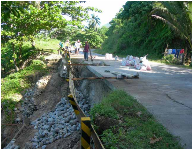
昨年末における台風による法面崩壊の改修現場。
