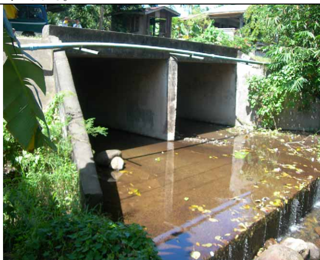
ポントド川に架かるボックスカルバート。 下流側の躯体には河床浸食防止のためのチェックダム(床固め工)が見られる。
