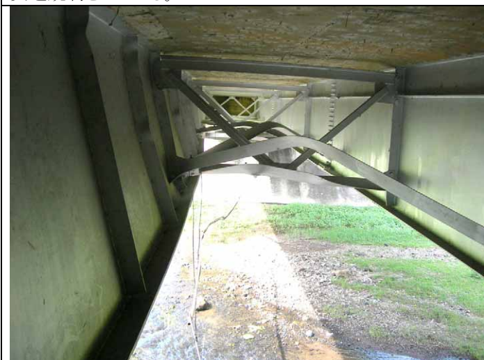
主桁の変形によって曲がった横構部材。一部の部材は横構としての機能を既に失っている。
