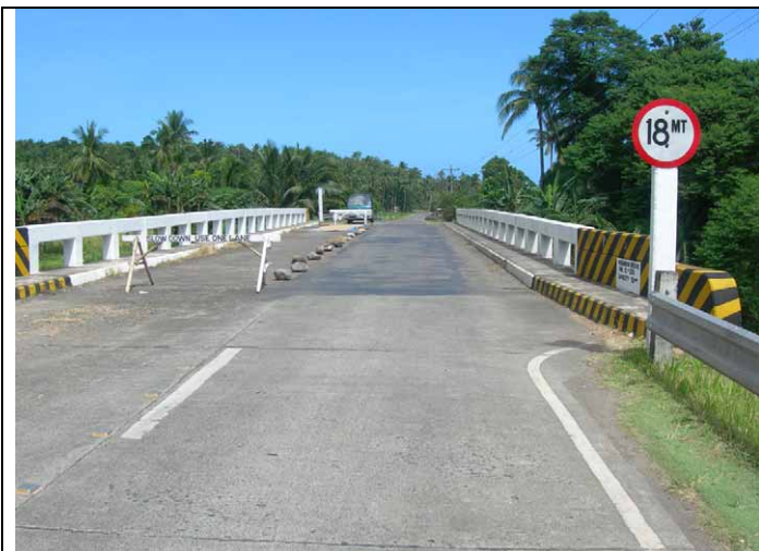
フバンゴン橋。橋長 35.6m、幅員 7.32m(車道部)。 上流側の車線は主桁が損傷を受け耐荷力が不足するため交通規制をしている。
