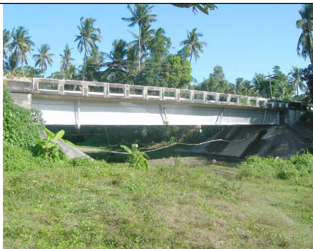
橋台はコンクリートで巻いて改修しているが、支持力の補強をしていないため、構造的にはあまり期待できないと考えられる。
