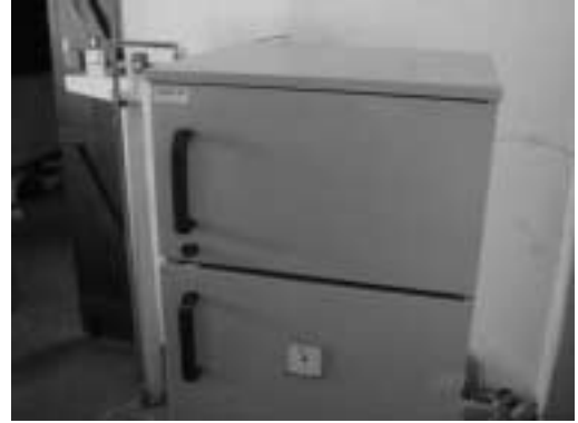
冷蔵庫(マハボボカ基礎保健センター) 1998年、UNICEFからの寄付、老朽化し適切な庫内温度を維持できなくなっている。
