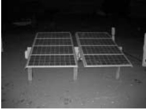
ソーラーパネル(トリアラ県内基礎保健センター) フランスの財団からの寄付、状態は良好。
