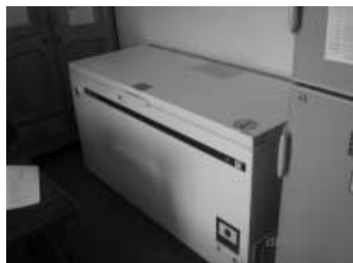
電気式冷凍庫 (アトドラマシ郡保健局) 2004 年、わが国無償資金より調達、ワクチン・アイスパックの冷凍使用、状態は良好。
