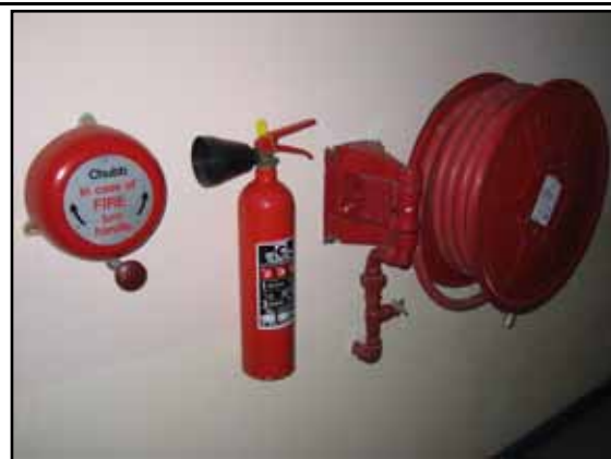
写真-18 SFA本部に設置された消火設備 左から火災警報器、消火器、消火ホースリール
