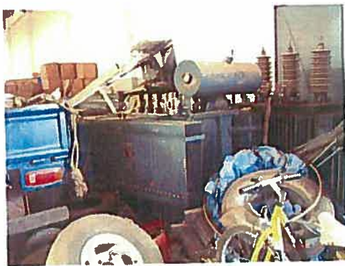
写真-21 同配電線工事用変圧器
