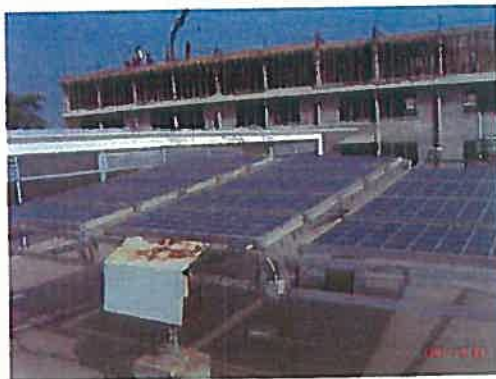
写真-5 同 PV パネル実験全景
