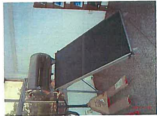
写真・12 同 ソーラーヒーター
