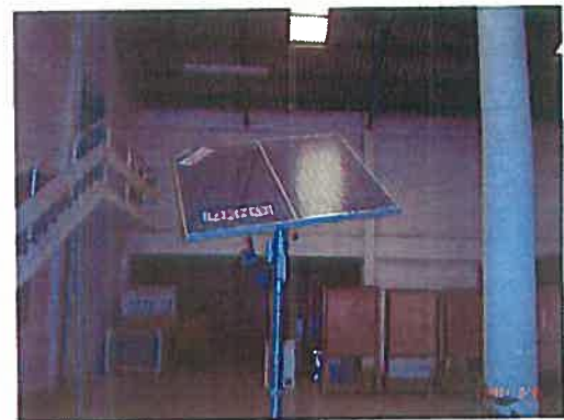
写真・14 同スタンド式PVパネル
