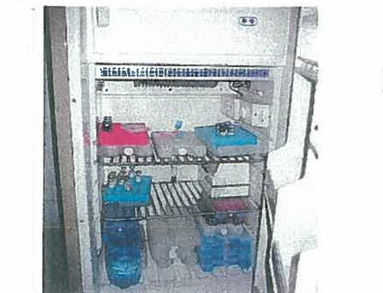
写真6 : バハダッド郡中央病院のワクチン保管用冷蔵庫。停電のため、冷蔵庫は稼働していない。1日に3時間以上停電した場合は、自家発電装置が稼働する。
