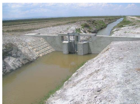
No.10 Système du canal principal du P5 de la zone d'irrigation du PC23 Arrêts de portes pour la réutilisation des eaux du canal tertiaire de drainage
