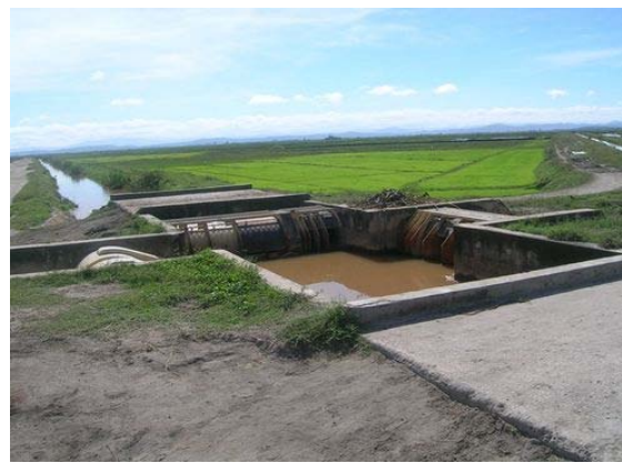
No.8 Système du canal principal du P5 de la zone d'irrigation du PC23 Rizière irriguée et ouvrages de dérivation du canal secondaire
