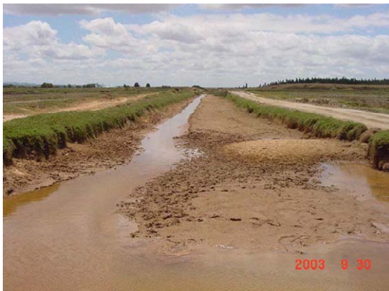
No.7 PC23 灌漑地区 Sahamilahy 川系統 P1 幹線用水路堆砂状態
