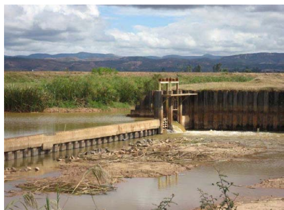
No.6 Sahabe 川乾期減水時の流況 PC23 灌漑地区 P1 幹線用水路仮頭首工 右岸下流側、対岸は P1 導水路入り口
