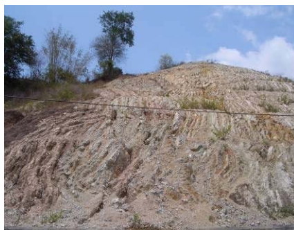
切り土のり面に発生したガリ A09 Viqueque
