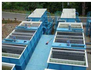
機械化を取り入れた浄水施設
