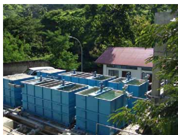
浄水場には多くの機械設備
