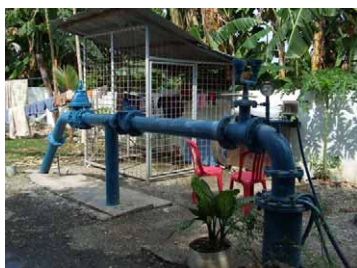
流量計が故障中
