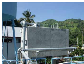
着水井と洗浄タンク
