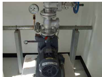
揚水ポンプは故障中
