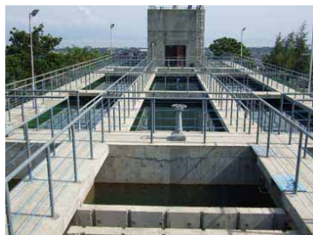
フロック形成地沈でん池
