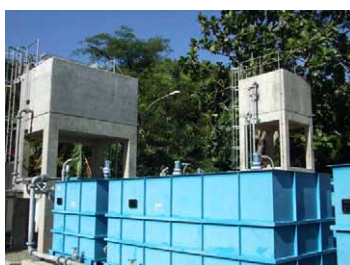
着水井と洗浄タンク
