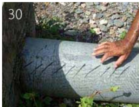
人為的な損傷?
