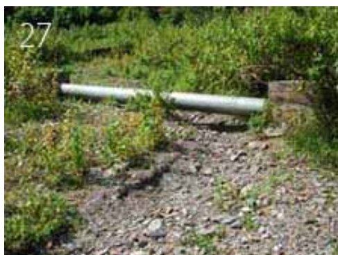
基礎が流水により洗掘され流失
