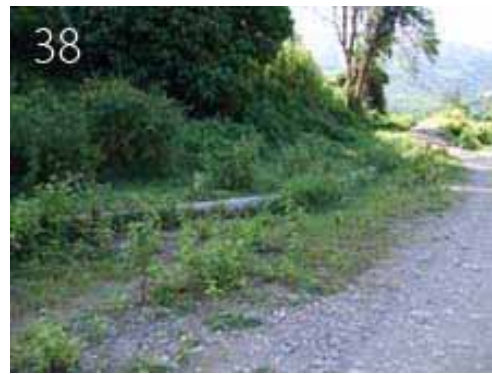
蛇籠が流出し配管露出
