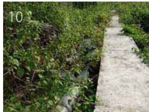
パイプの損傷が至る所に 見られる
