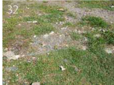
泥吐き（排砂）管が使用されたのは、工事後の一回だけ
