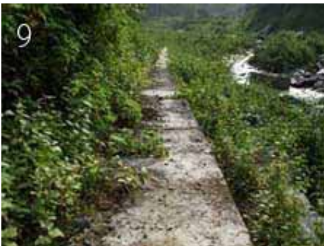
コンクリート架台が流され DNSASが補強した区間約75m
