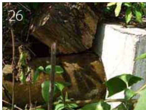
ここも落石のためコンクリートにひび割れ
