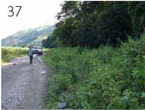
道路表層が流され配管は地上に露出
