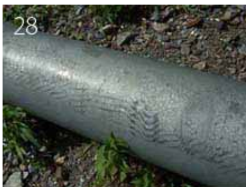
転石、滑石による損傷
