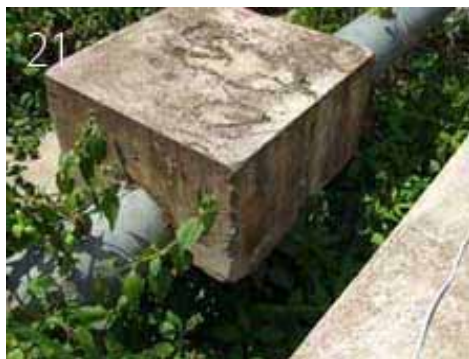
栗石が流失し浮いている架台 (DNSAS が補強した部分が残る)
