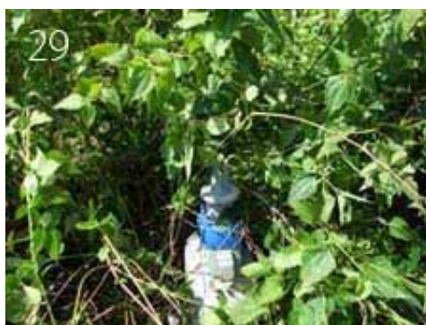
茂みに隠れた仕切弁、弁筐は流失
