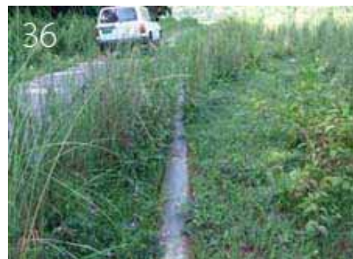
覆土が流失し配管露出
