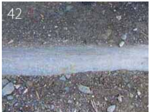
道路表面に配管が露出、空気弁蓋 蓋も紛失
