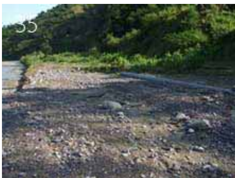
洗掘によりアクセス道路、蛇籠が流失
