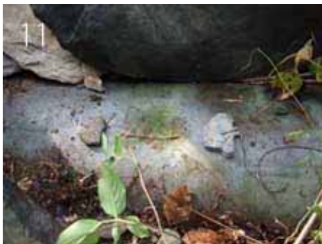
落石による損傷
