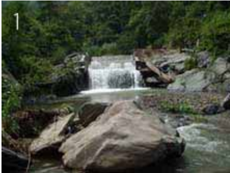
堰下流側から撮影 越流堰エプロン部の根固め工が流失
