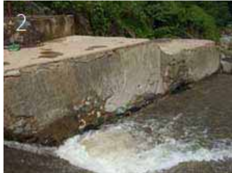
取水堰左岸にある排砂管機能せず、 排砂管口径 80mm
