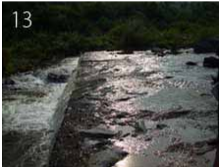
13 下流側が洗掘を受けている
