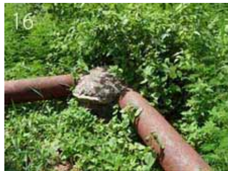
16 DNSAS が敷設した排砂用のバイパス管、塗装が不十分
