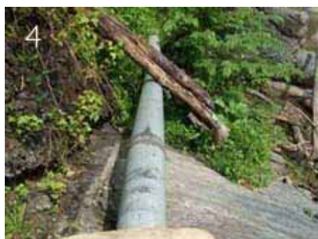
取水堰左岸部の配管露出部
