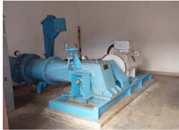
Chendebji マイクロ水力発電設備 (70kW)
