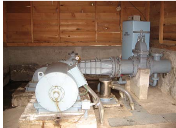
Rukubji マイクロ水力発電設備 (40kW) Department of Livestock から 2003 年に供与され た冷蔵庫 (写真右奥) も併設されている。
