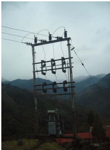
Thimphu 以外の地方はすべて架空配電 変圧器はH柱の柱上もしくは地上設置
