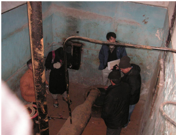
第1ステーション(稼動していない井戸ポンプ室)
