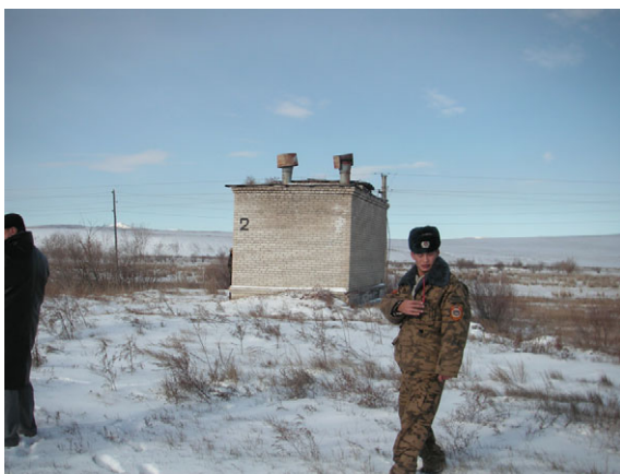
第1ステーション (稼動している井戸ポンプ室)
