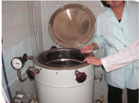
ダルハン市上下水道公社内ラボ（1982年購入のロシア製のオートクレーブ：水漏れして危険である）
