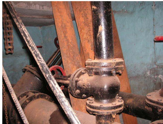
第1ステーション (稼動していない井戸ポンプ室、老朽化した配管及びバルブ)
