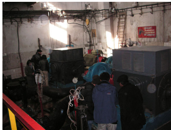
第2ステーション（送水ポンプ室、運転中の状況）
