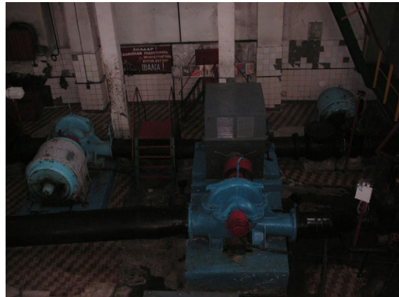
第2ステーション（送水ポンプ室、運転中の状況）
