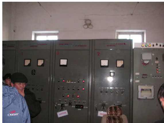
第2ステーション（送水ポンプ室、電気制御盤）
