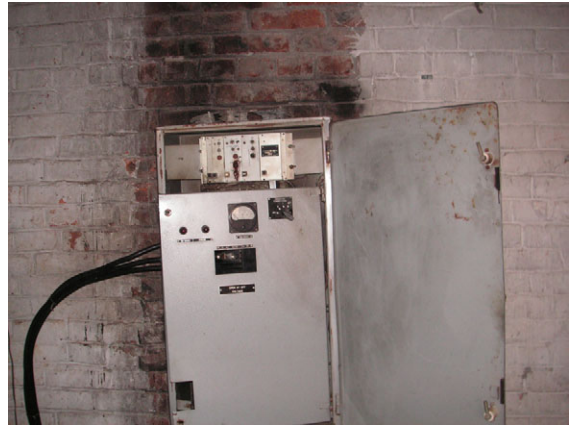
第1ステーション（稼動中の井戸ポンプ室、運転操作盤）
