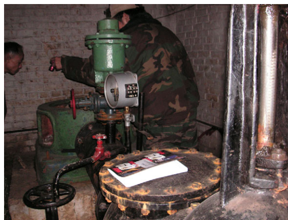
第1ステーション (稼動している井戸ポンプ室、運転中のポンプ装置)
