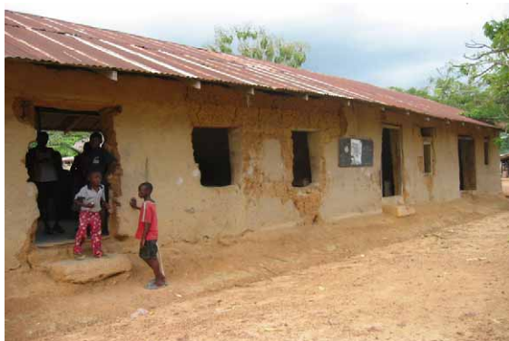
土壁造の教室棟外観 (老朽化が顕著である)
