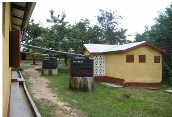
雨水貯水タンク、トイレ棟
