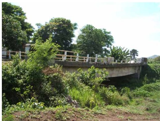
橋梁 州道 069.3 号 RCT 橋梁 (たわみ大)
