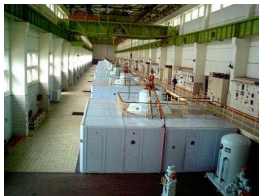
発電機 (18MW×10機)
