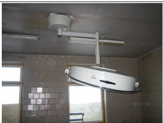
Операционная лампа, монтированный в потолок
