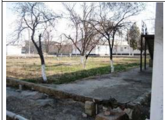
州皮膚科/性感染症ディスペンサリー： 老朽化した給水配管システム
