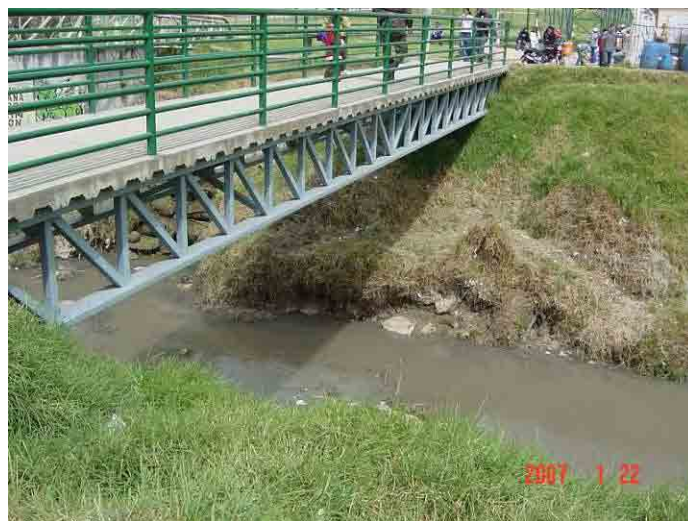
Foto S8-2-6 Puente peatonal para la instalación del Sensor Ultrasónico
