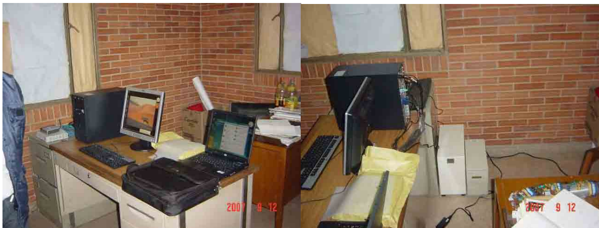
Foto S8-2-11 Computadores, enrutador y UPS en la estación de Bomberos
