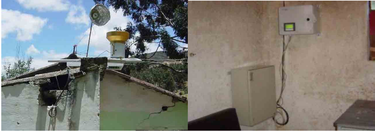
Foto S8-2-13 Pluviómetro en el techo, Colector de datos y fuente de poder
