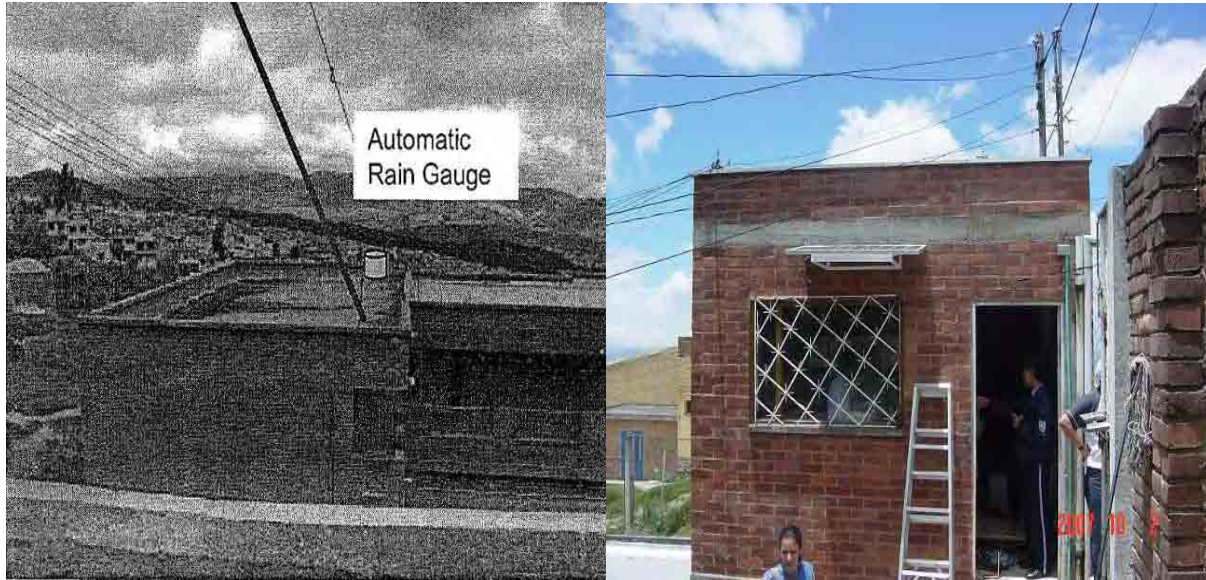
Foto S8-2-2 Pluviómetro y Panel Solar en Moralba
