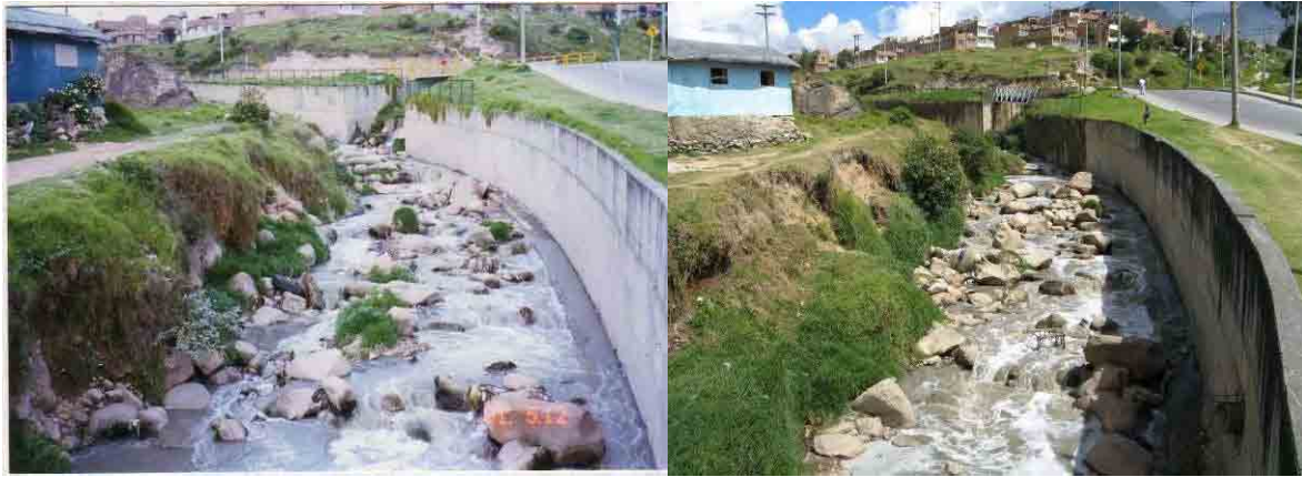
Foto S6-1-1 Condición del Lecho del río en Los Puentes en la quebrada Chiguaza (Izq.: Mayo 12, 2001, Derecha: Enero 16, 2007)
