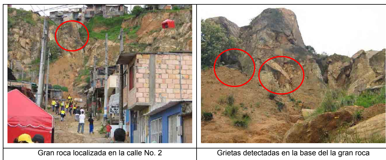
Figura 1 Ubicación del Bloque Grande y las Grietas Detectadas
