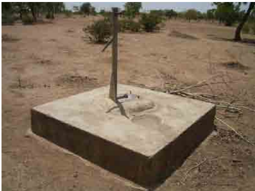
放棄された人力ポンプ付深井戸給水施設
