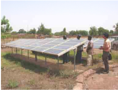
既存簡易給水施設のソーラーパネル
