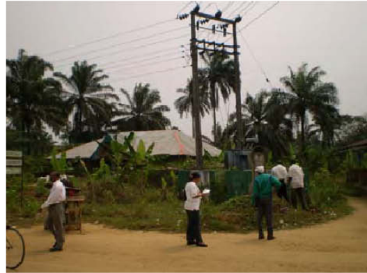
既設配電用変圧器の様子
