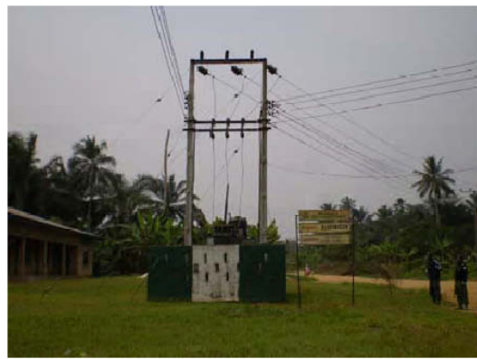
既設 33kV 配電線との接続点
