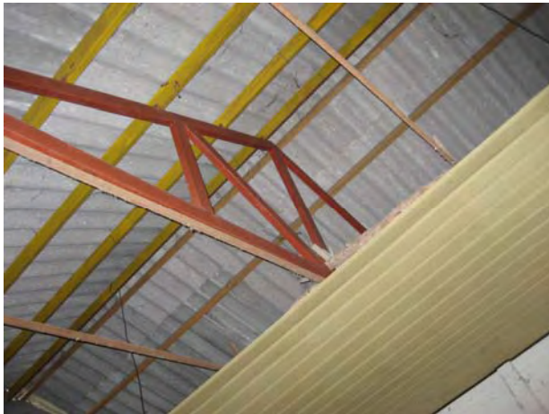
既存 初等学校の劣化状況（天井パネルの脱落） 天井パネルが脱落している教室が多く確認される。
