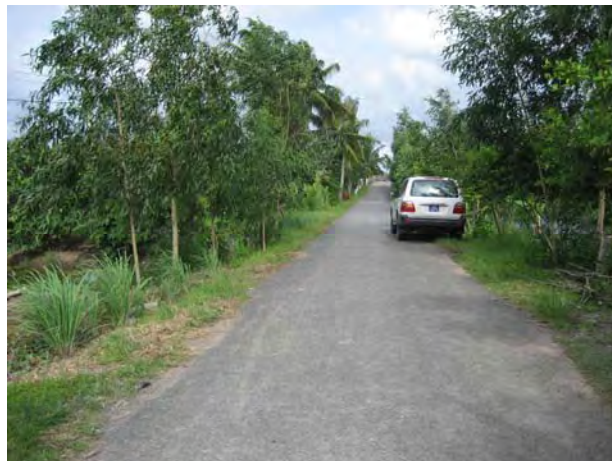
既存の省道路の様子 要請されている省道路の仕様は幅 3.5m、アスファルト舗装である。現状、車両は路肩に乗り上げて離合を行っているが、現地の主な交通手段はバイクであるため十分な幅である。
