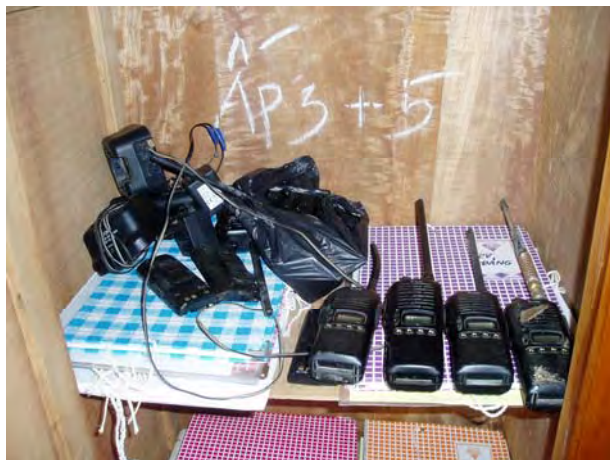
森林会社で使用されている通信設備
