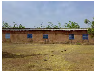
屋根亜鉛鋼板の損傷。
