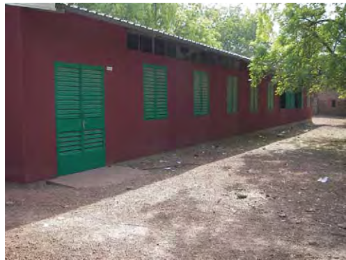
校舎の背面 (扉は倉庫、地盤から床が低い)
