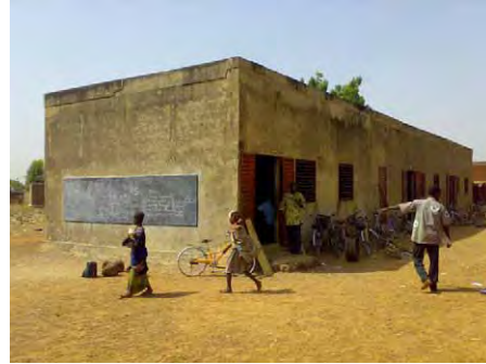
既存校舎全景。外壁、床の劣化が進んでいる。
