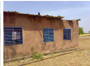
屋根亜鉛鋼板の損傷。
