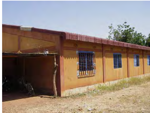
校舎の背面 (屋根の一部が破損している)
