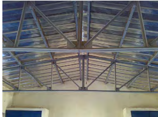
トラス支間中央部に撓みが発生している
