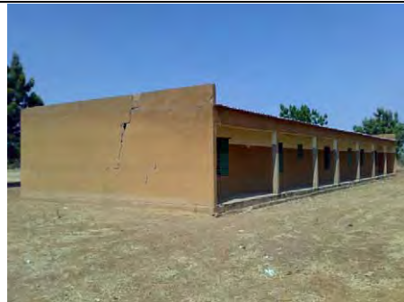
既存校舎。両妻側壁には大きなクラック入っている
