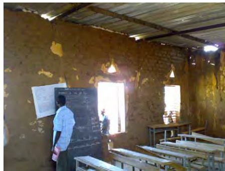
既存教室内部。屋根架構と外壁取り合い部の損傷が著しい。
