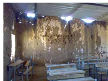
外壁の著しい損傷。
