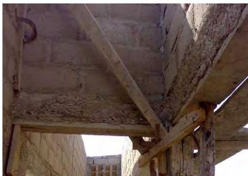
梁コンクリートのジャンカ
