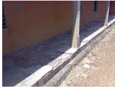
外廊下床スラブの劣化。コンクリートの品質に起因すると思われる
