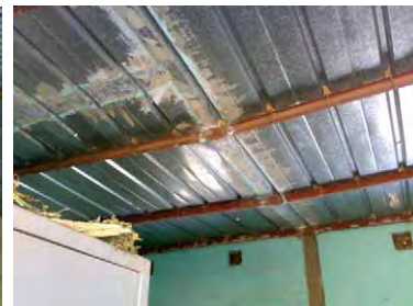
耐力壁が取り除かれ母屋が撓んでいる
