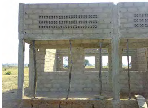
不十分な支保工による梁の撓み、柱の断面欠損
