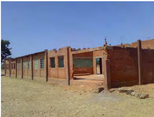
屋根が倒壊し消失
