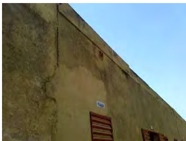
外壁モルタルは剥離している
