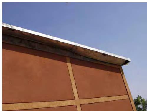
校舎の妻側 (軒先が破損している)
