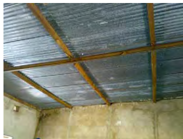
母屋（形鋼）および垂木（桟木）針金のみの固定
