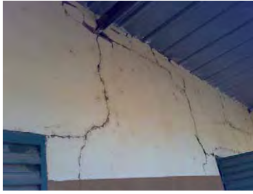
桁行き方向耐力壁の大きなクラック
