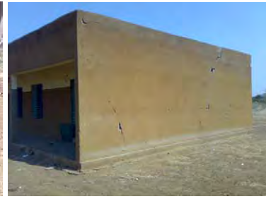
妻壁の構造クラック。外廊下部分の不等沈下に起因すると思われる
