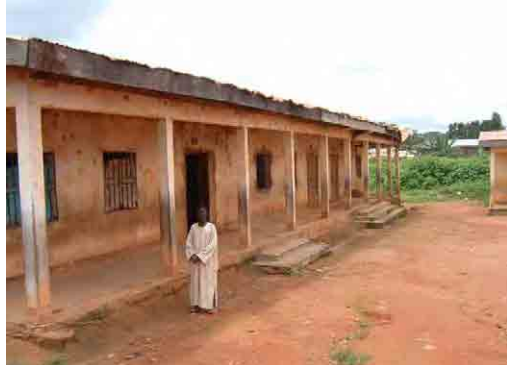
隣地河川の氾濫で毎年のように洪水被害を被る
