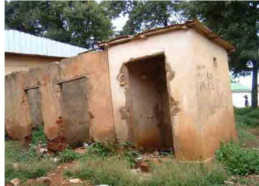
「カ」国政府により建設された便所棟であるが地盤と基礎の不具合で転倒
