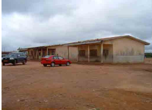
1990年 「カ」国政府により建設された教室棟 各所不具合はあるが改修工事で対応可能
