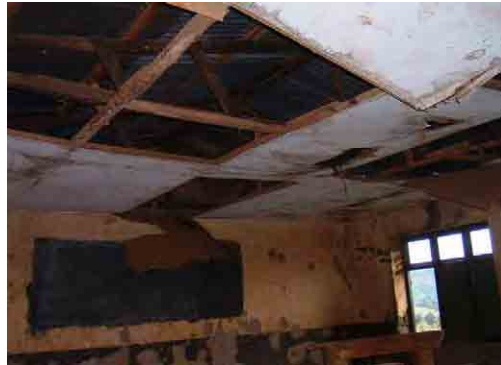
天井の不具合はあるが改修工事で対応可能
