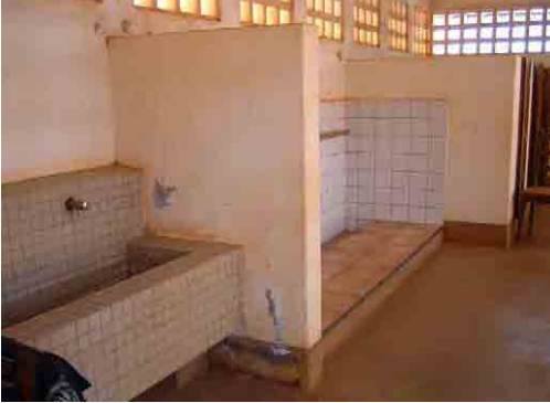
便所棟手洗場（水洗式）
