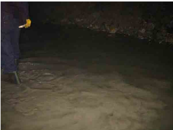
暗い坑内を歩いたが、廊下にはヘドロは相当溜まっており歩き難い。
