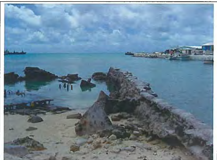
旧港西防波堤の破損状況、対岸は漁業棧橋
