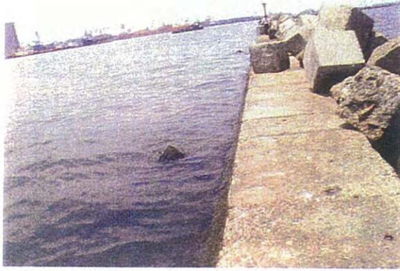
現場視察（転落消波ブロック）
