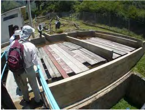
アランフェス浄水場の既設沈でん池。容量が過小で十分機能していない。
