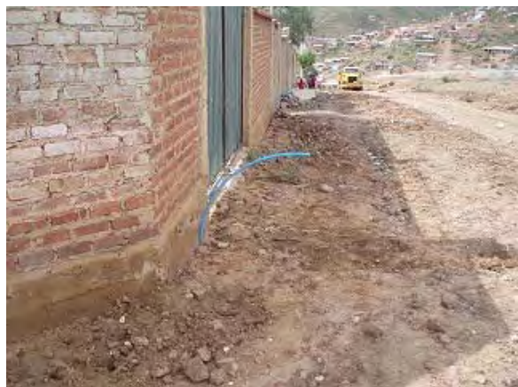
水組合からの運搬給水を受水するためのホース。運搬給水の水質だけでなく、受け入れる施設も劣悪である。
