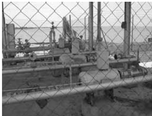
P8 破損して使われていない荷油ポンプ
