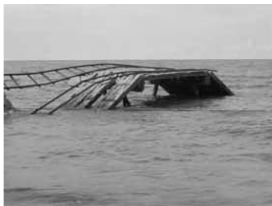
P94 崩壊した Jetty
