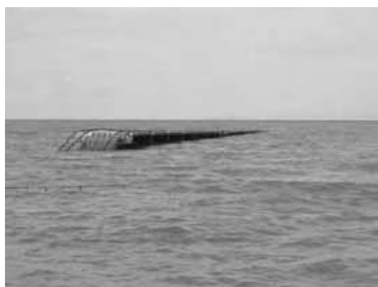
P96 浜から 100mくらい沖まで続く 崩壊した Jetty,
