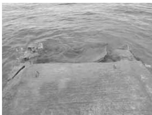
P60 突堤前端は損傷している
