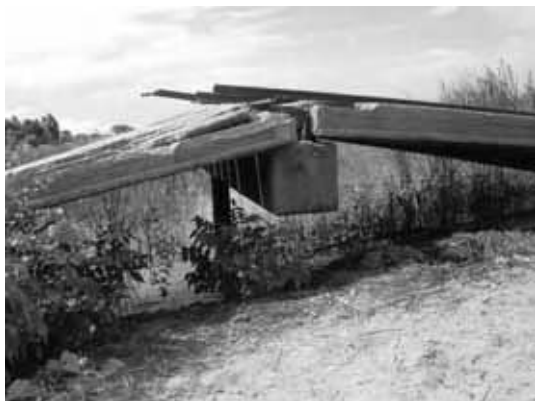
P91 木製支柱が腐食崩壊 何とも不思議なバランスである
