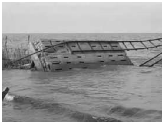
P93 崩壊した Jetty
