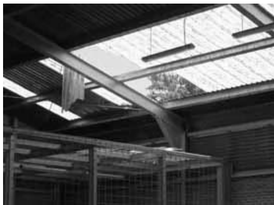
P45 倉庫の天井は破損
