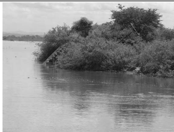
対岸左側の部分の Up、レールが水面に向かって垂れ下がっているのが見える。
