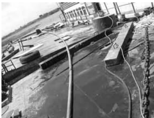
P22 川が浅いため着底している浮き桟橋
