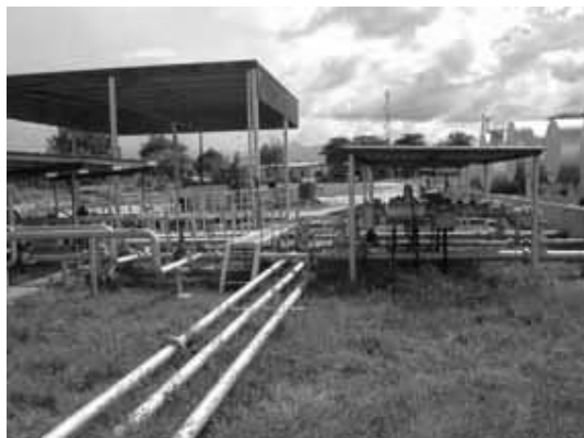
P13 オイルポンプとパイピング
