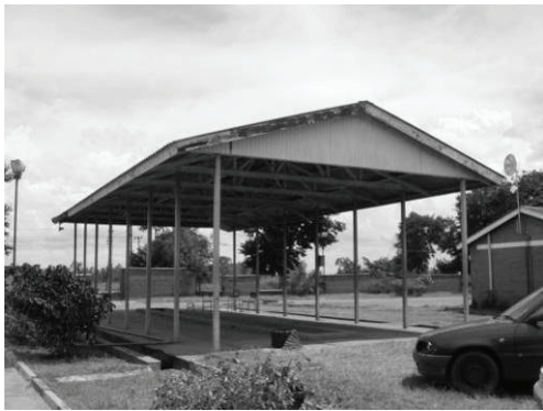
車両検査施設。
