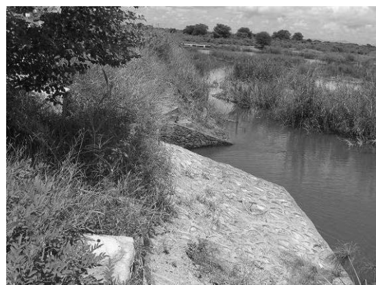
堰堤にはいくつもカルバートが設けられていて、通水するようになっているが、洪水時、これでは通水断面積が足りず、先端部で流失した。
