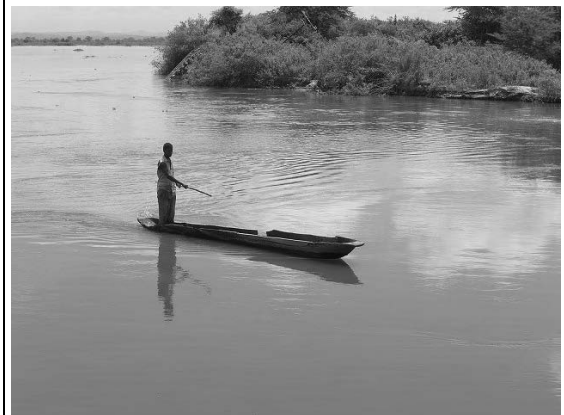
対岸まで約 100m にわたって、堰堤が流失している。現在はこの間を渡し舟が、人、自転車等を運んでいる。
